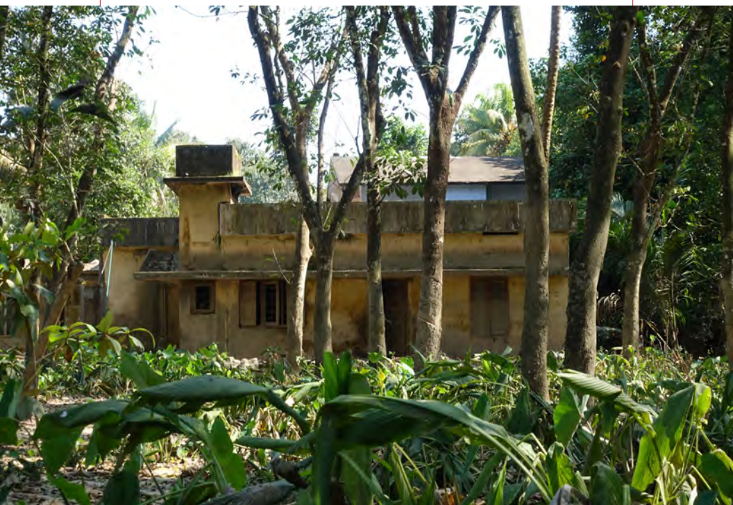
As inundações chegaram quase ao teto dessa casa em Ranni Angadi. Arquivo Popular da Índia Rural / P. Sainath
