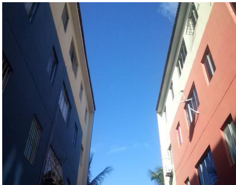
Figura 32: Fachada dos edifícios e a falta de proteção das janelas. Fotografia: Autora.
