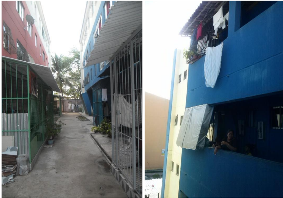
Figuras 34 e 35: Ampliação dos apartamentos (terraços) improvisada pelos moradores.
